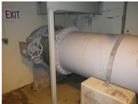
Biotower effluent pipe
